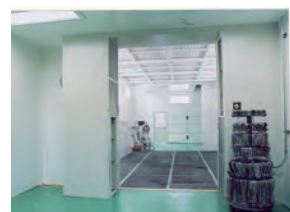
塗装ブース入口 (長崎県 T社様電機メーカー)
